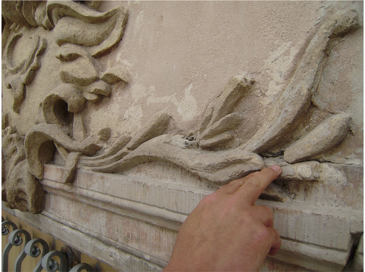
Elewacja wschodnia Zamku Królewskiego fragment dekoracji rokokowej wymagającej uzupełnień
